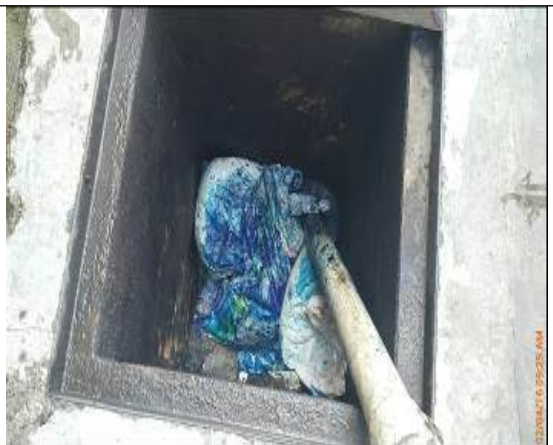
Foto No. 15. Detalle Caja de Inspección Externa que recibe el derrame de sustancia peligrosa Tinta CYAN
