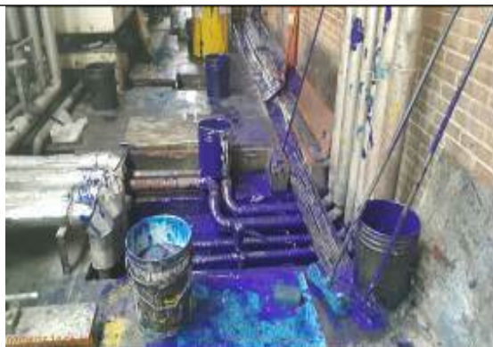
Foto No. 12. Detalle área colindante a la tubería donde se presentó el derrame de sustancia peligrosa Tinta CYAN
