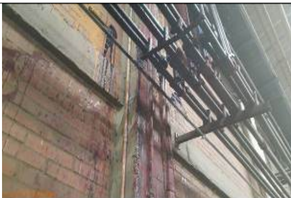
Foto No. 11. Detalle Tubería donde se presentó la rotura y que generó el derrame de sustancia peligrosa Tinta CYAN y evidencia de manchas en la pared de tinta color Magenta y Amarillo
